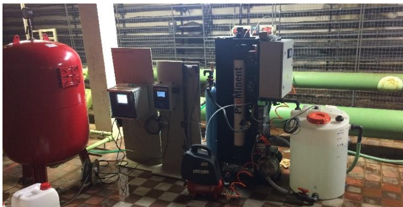
Obr. 5. Fotografie ultrafiltračního poloprovozního zařízení
