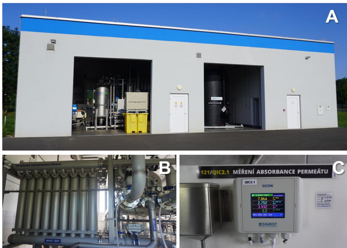
Obr. 1. Celkový pohled na objekt úpravný vody pro Velký bolevecký rybník (A), detailní pohled na technologii keramických membrán - vlevo housingy jednotlivých membrán, vpravo armaturní část technologie (B), převodník kontinuálního měření absorbance permeátu (C)
